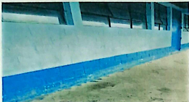
Fotografía 1: Se observa el deterioro del piso de torta de concreto en el pacillo por lo que instalará piso cerámico antideslizante.
